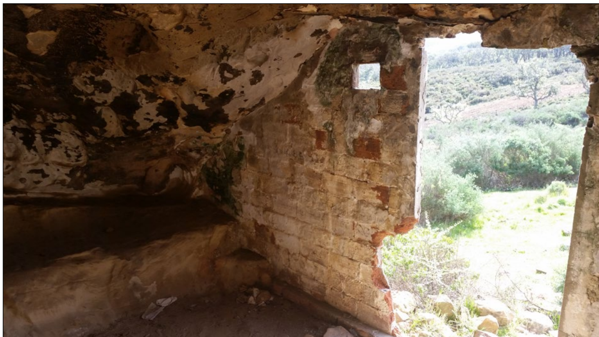
Lámina 4. Zona donde dormían sus padres. Junto al vano de acceso, una de las ventanas que se cubrían con corcho. Imagen de los autores
