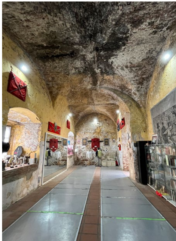
Lámina 12. Los problemas de humedades aparecen en todas las estancias que no han sido restauradas recientemente. Imagen de P. Gurriarán
