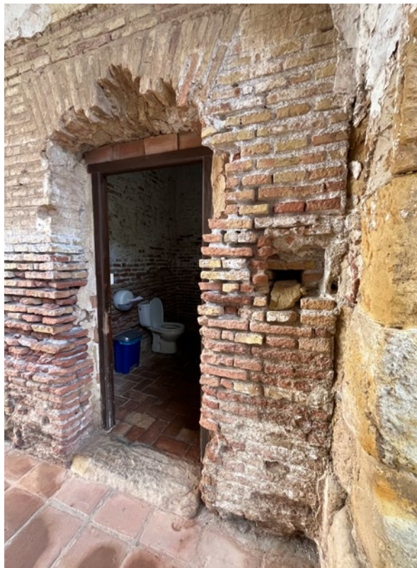
Lámina 11. Deterioro de paramentos y dintel. Imagen de P. Gurriarán
