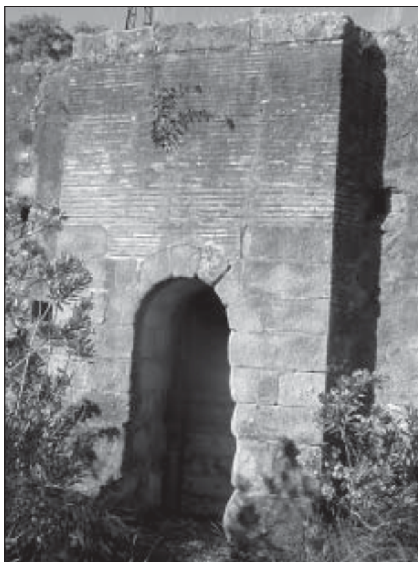
Ilustración 3. Toma de agua (tragante) al inicio del canal del Hozgarganta.
