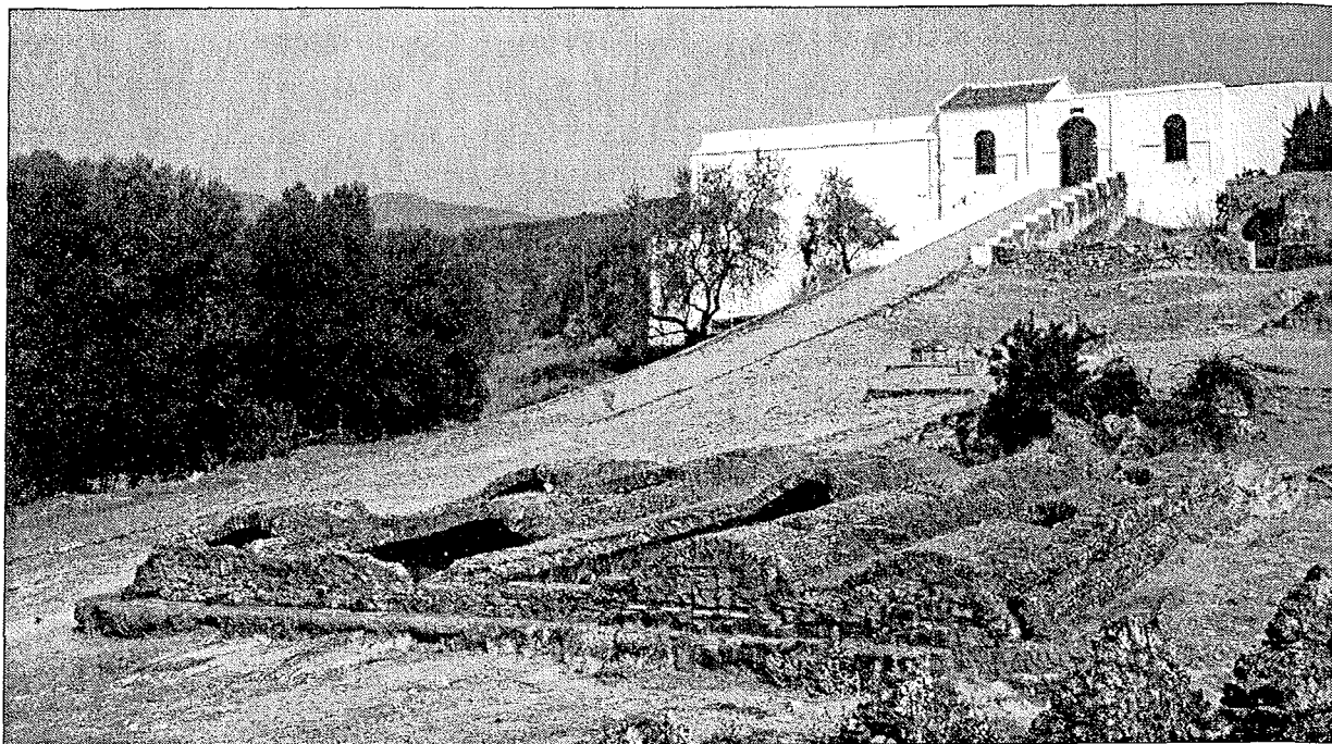
Figura 1. Vista general del aljibe central desde la Torre del Reloj. Se notan la plataforma que rodea el aljibe y el estado deteriorado de las bóvedas de cañón.
