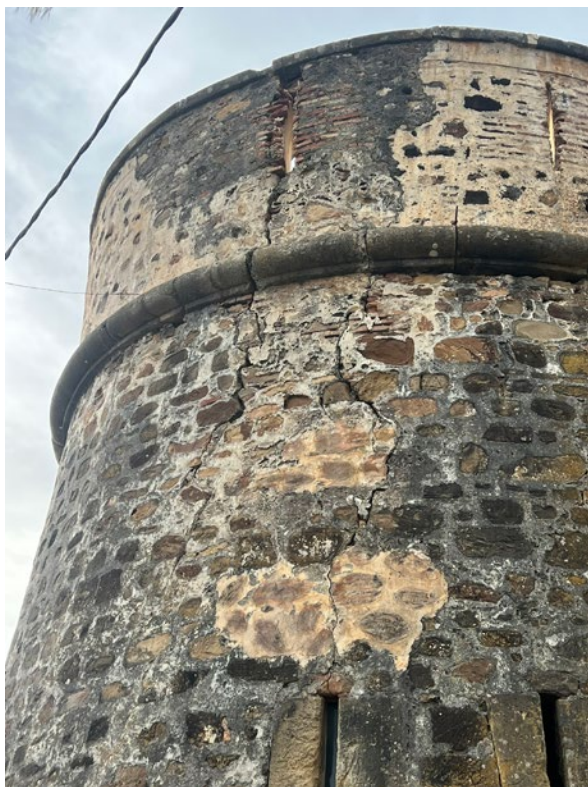
Lámina 9. Grietas en el torreón septentrional de la fortaleza. Imagen de A. Sáez
