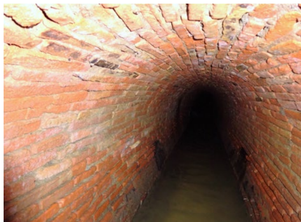
Lámina 10. Aspecto que presenta la alcantarilla en la calle Sancho el Bravo. Imagen del autor
