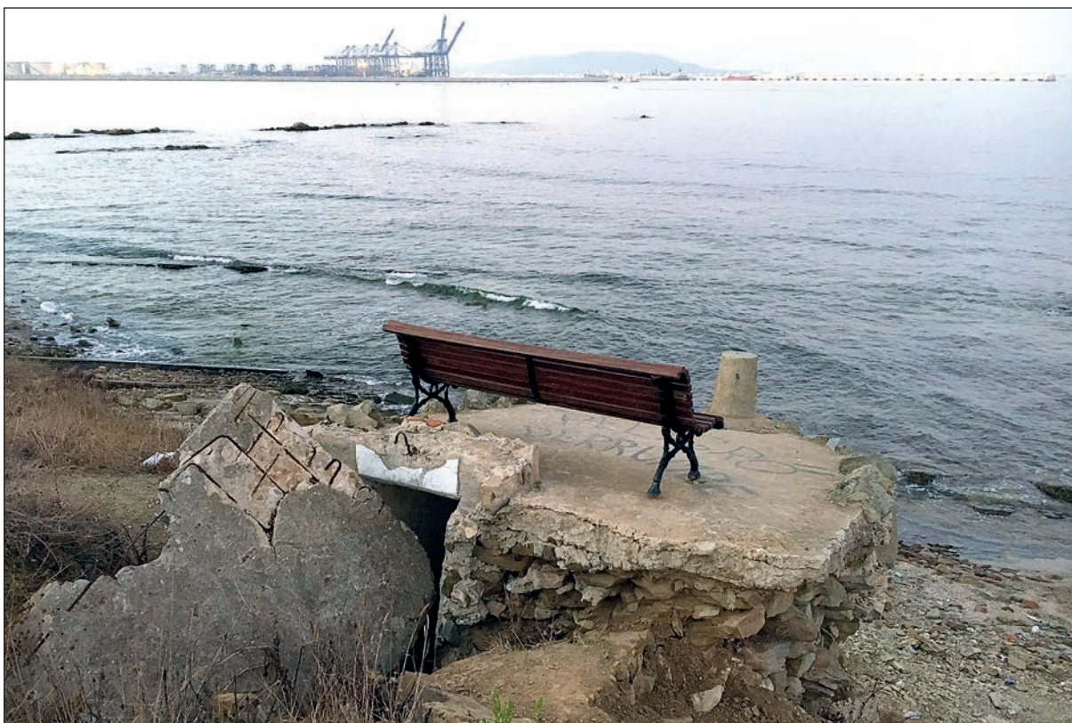
Lámina 3. Fortín número 310 del Parque del Centenario (punta de San García, Algeciras). A pesar de encontrarse seriamente deteriorado y con riesgo de desplome, en 2016 se le colocó un banco en el techo, para que la ciudadanía pudiese contemplar, plácidamente, el bello paisaje de la bahía de Algeciras. Fotografía de A. Sáez
