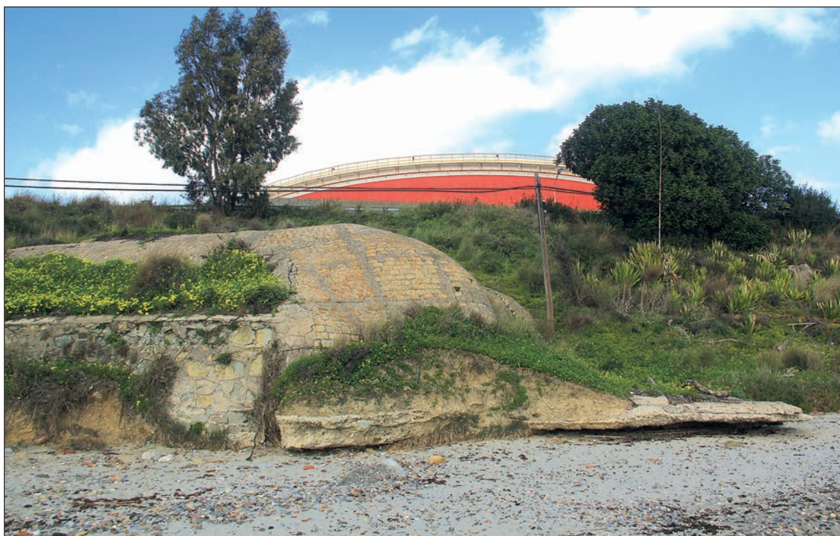
Lámina 6. Estado del fortín número 176, en 2017, en la punta del Gallo (Guadarranque, San Roque). Presentaba diversas y graves deficiencias estructurales, como el descalzado de sus estructuras por efecto del oleaje. Una reciente intervención de la Autoridad Portuaria de la Bahía de Algeciras ha consolidado el edificio. Fotografía de A. Sáez
