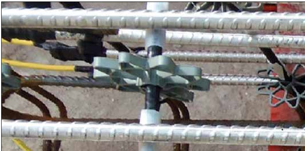
Lámina 2. Aislamiento entre el acero inoxidable y el acero al carbono. Imagen de los autores
