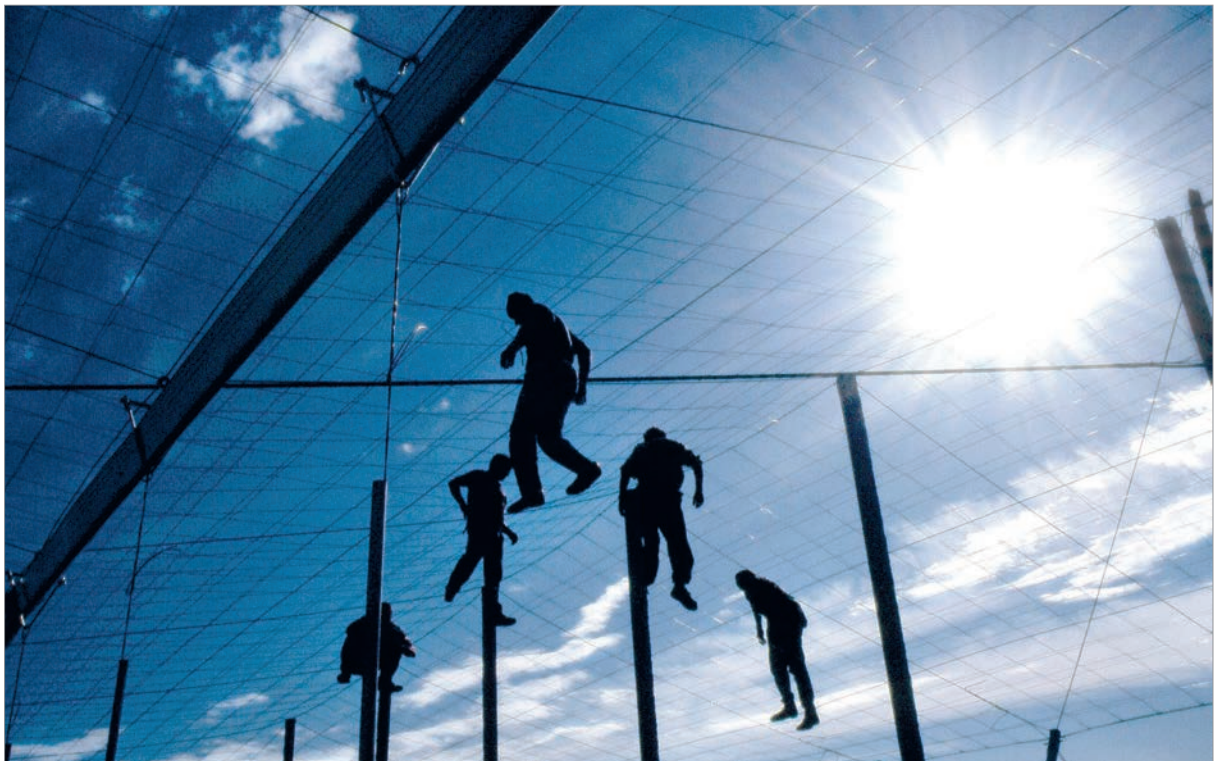
Una cuadrilla de inmigrantes irregulares trabaja en la construcción de un invernadero La Mojonera, Almería, España. Diciembre 1995
