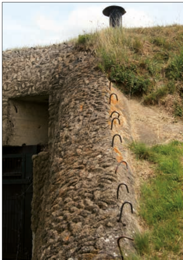
Lámina 4. Batería Merville en Normandía (Muralla del Atlántico, Francia) en 2012. Fijaciones para redes de mimetización. Imagen de Ángel Sáez
