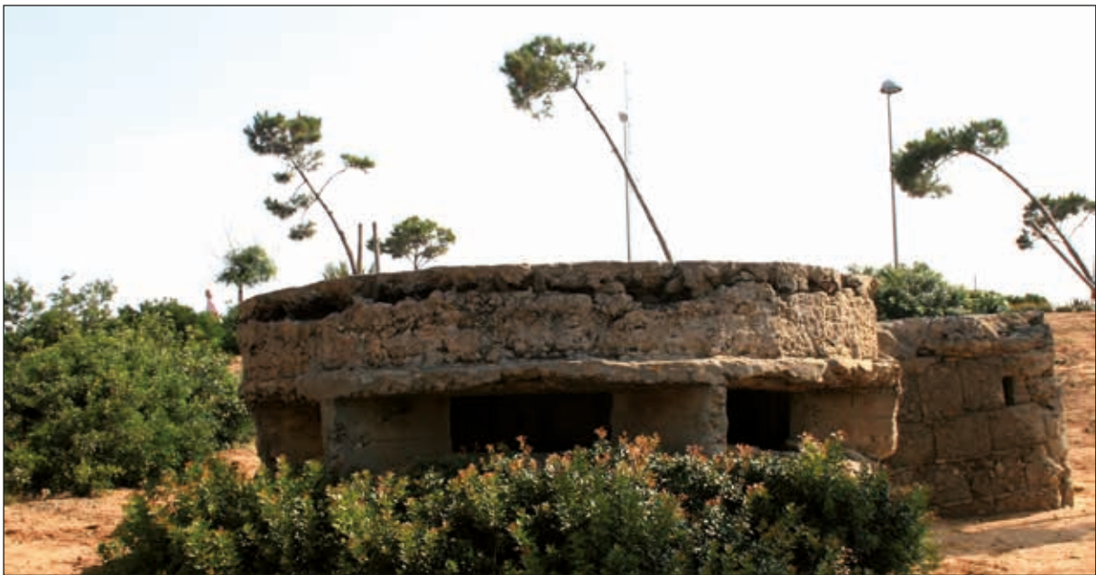
Lámina 14. (arriba). Nido de ametralladoras 474 (obra IV-B-26) de Conil de la Frontera - Cádiz. AGMAV-M-2377-2 detalle
