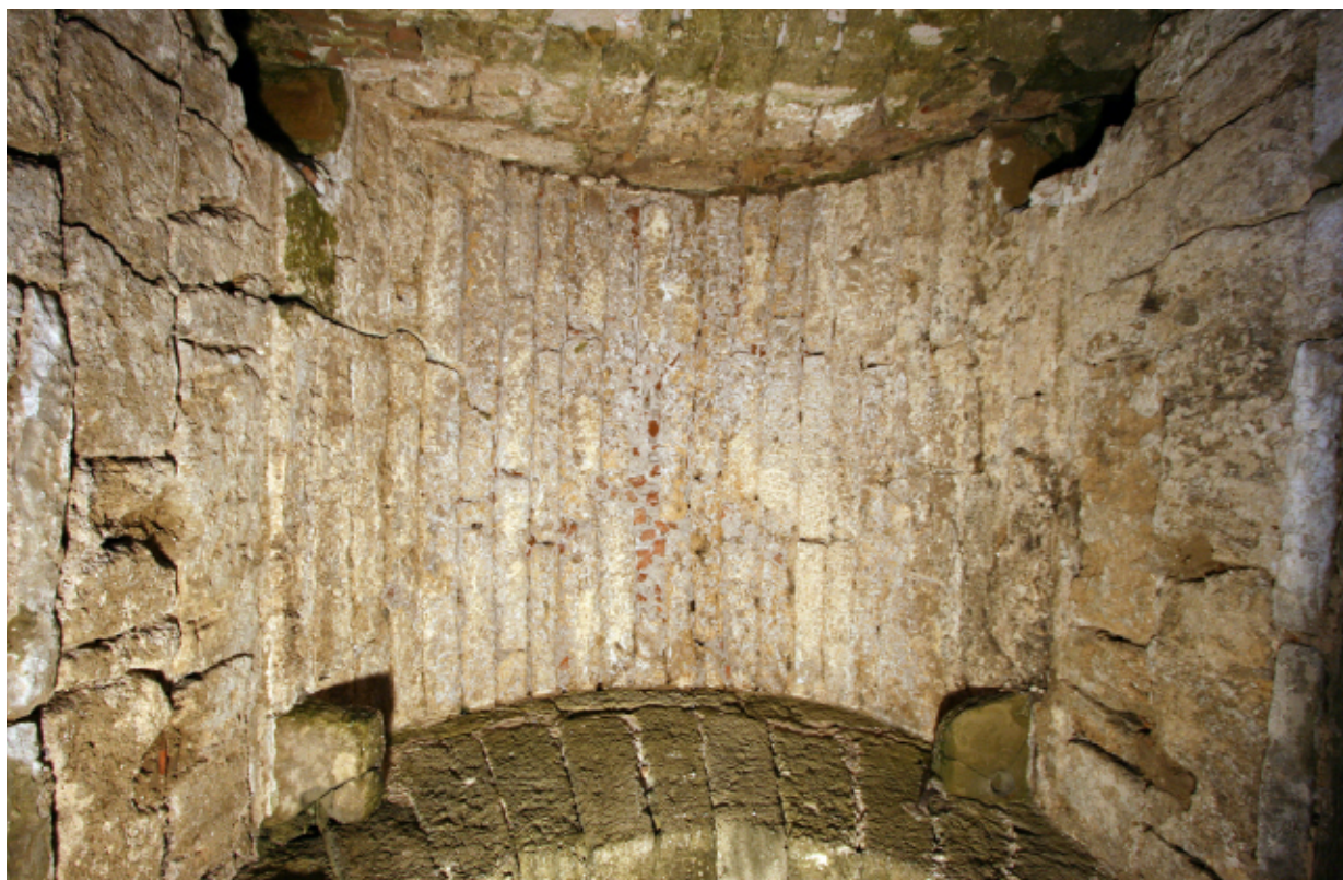
Ilustración nº 4. Detalle de la bóveda de medio cañón del pasadizo de la Puerta de la Lápida.
