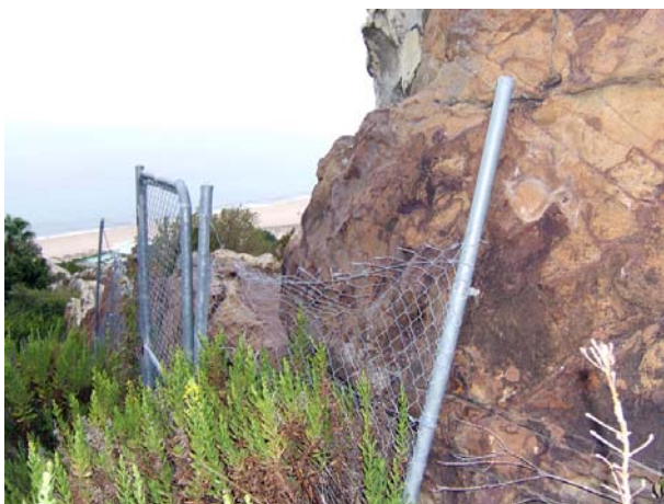
Vallado: en vez de proteger, facilita el acceso
